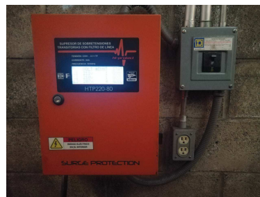
Figura 2.3: Breaker para el flujo de corriente
