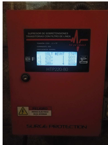
Figura 2.2: Centro de carga
